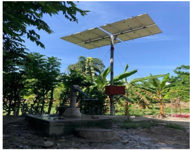
Photo de la pompe solaire installée sur puits Comme il faut
