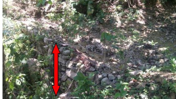
Figure 7 : Seuil en pierres rempli des sédiments Ntumba W., 2015
